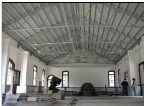
丸山変電所(内部)
